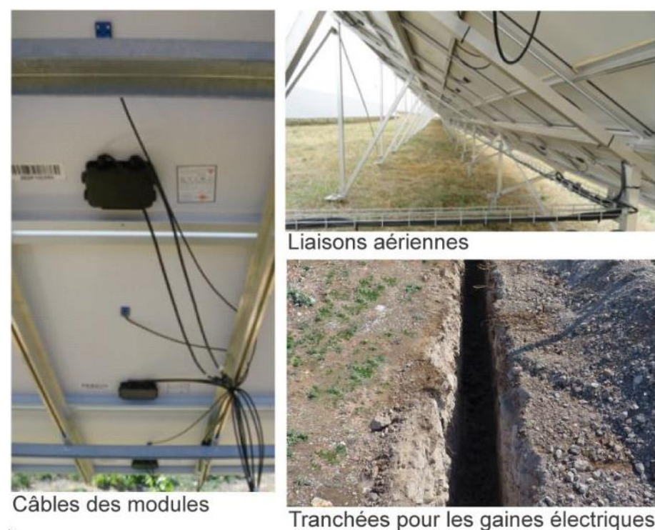
Photographie 8 : Liaisons électriques (Source : ENCIS Environnement)
