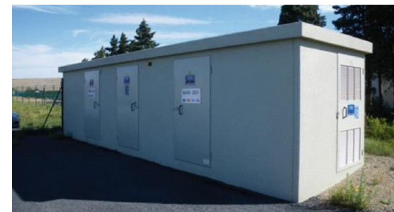
Photographie 7 : Poste de livraison (Source : ENCIS Environnement)
