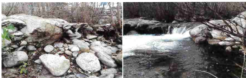
Endommagement des ouvrages
