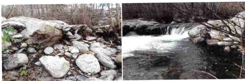
Endommagement des ouvrages
