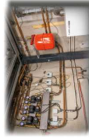
Panopie hydraulique avec les trois départs
